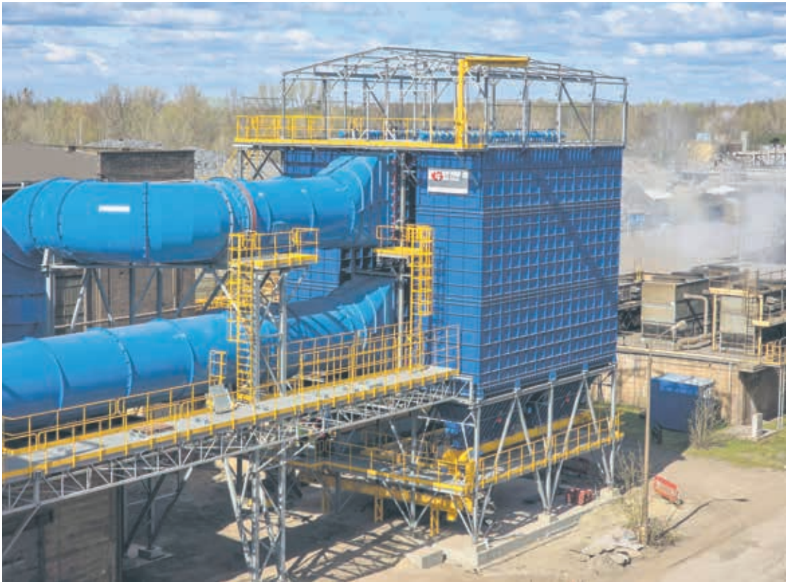
Huta ArcelorMittal Warszawa - system odpylania stalowni.
